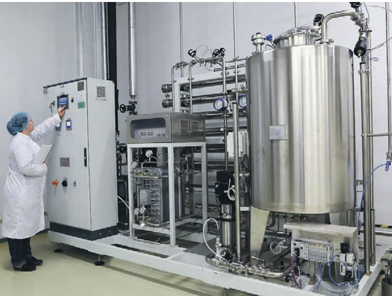
Чтобы обеспечить высокие стандарты GMP, завод «Ниармедик Фарма» оснащен по последнему слову техники. На снимке: система очистки воды
